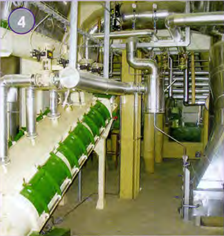
4 - Les conditionneurs pour le traitement thermique
